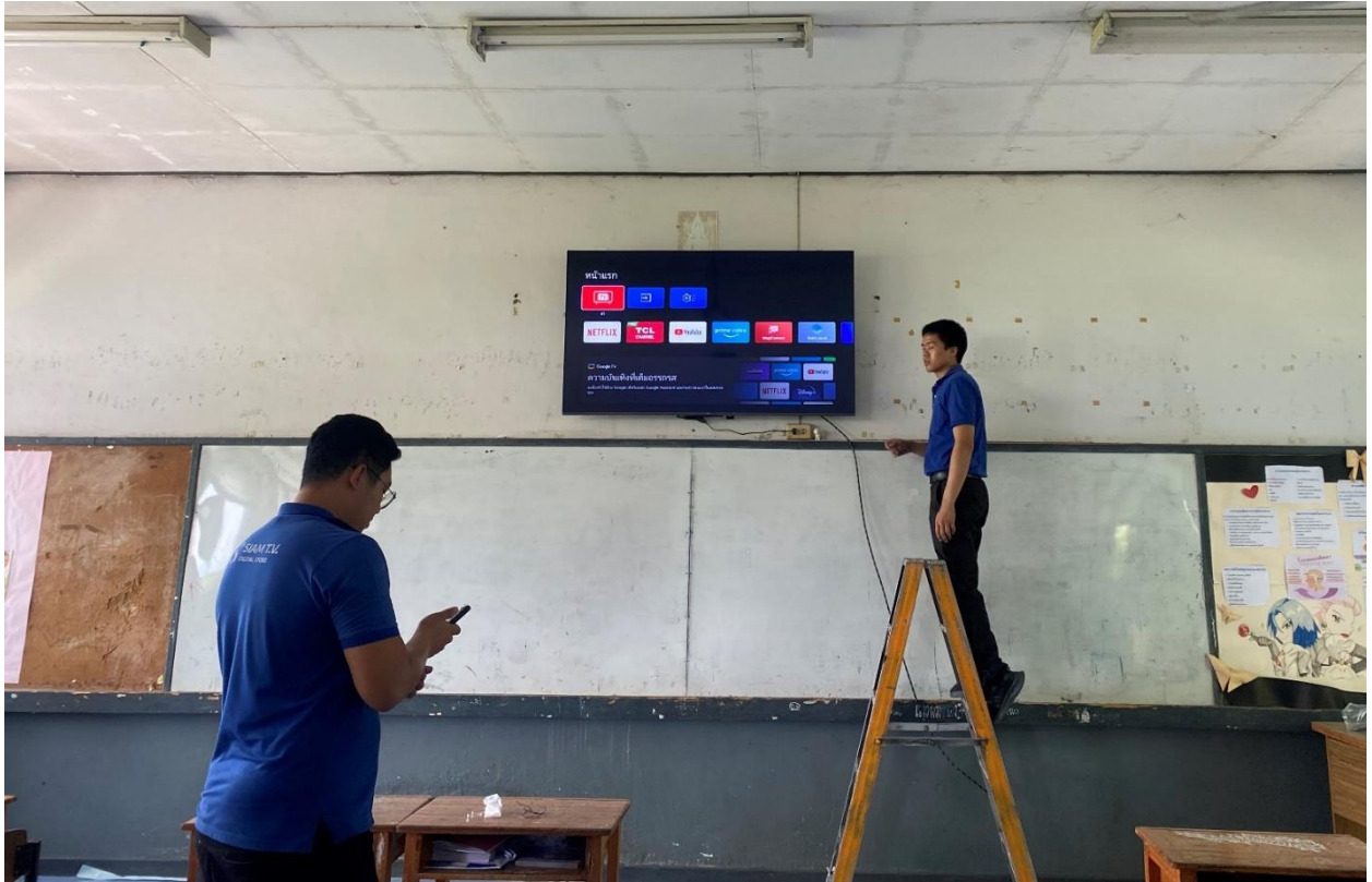
การติดตั้งทีวี สำหรับการจัดการเรียนการสอน
